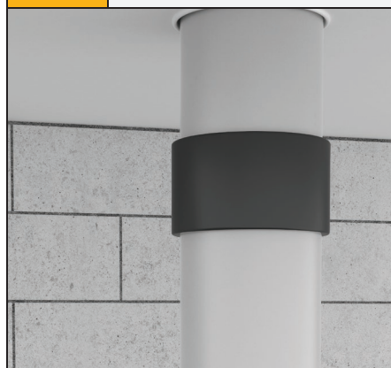
obr. 2 Prostup hořlavého potrubí stropem
